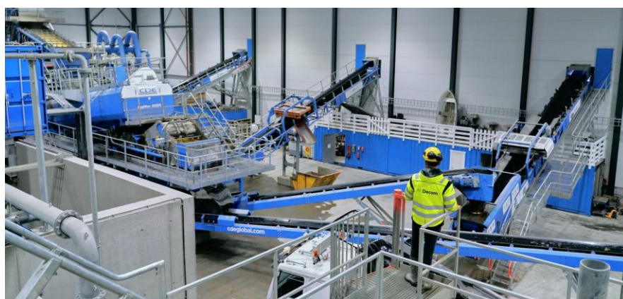
Illustrasjon 1: Nes Miljøpark, anlegg for gjenvinning av forurenset masse
